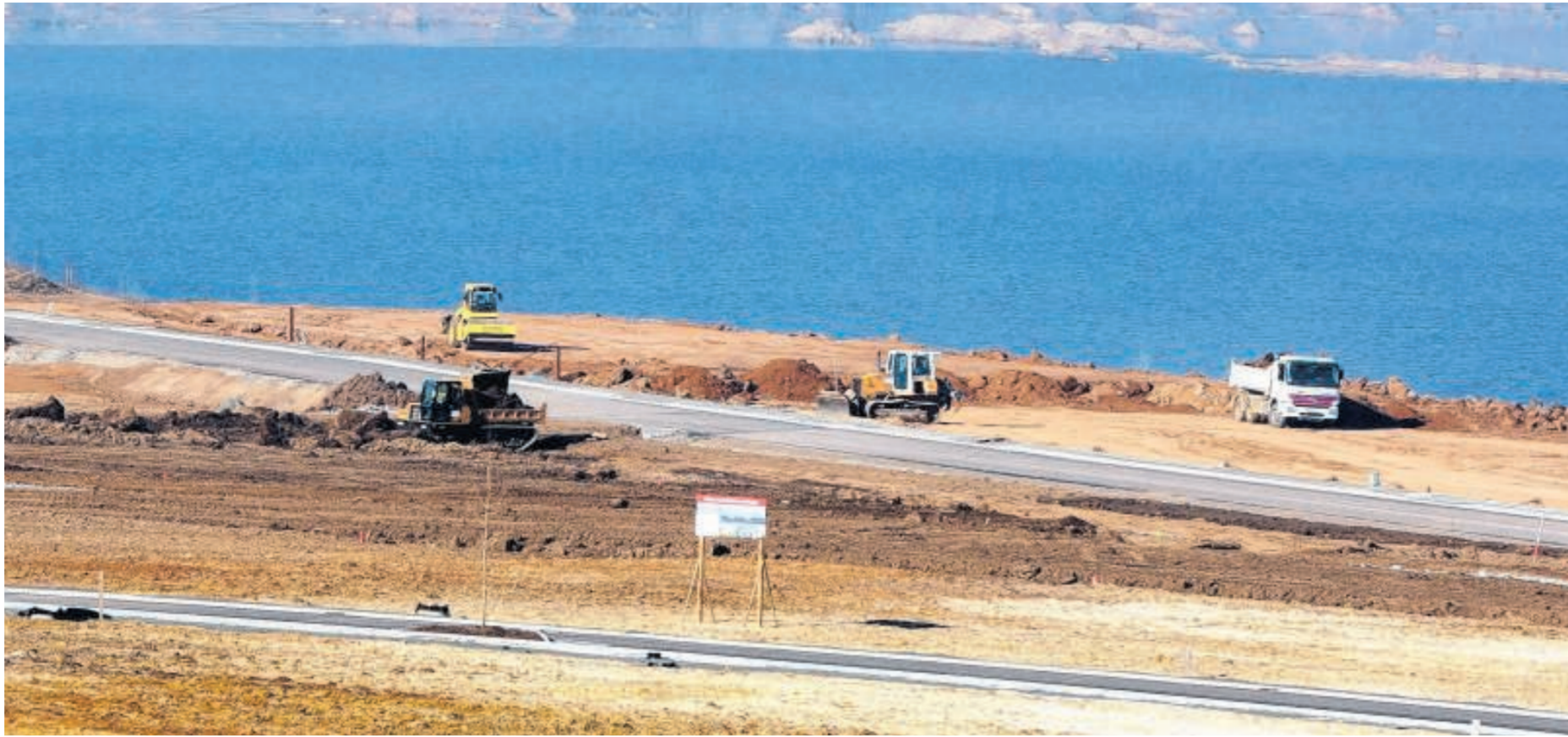
Vorbereitung auf den Boom: Der Zwenkauer See ist schon jetzt bei Investoren beliebt.
